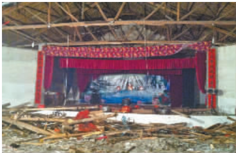
婚礼现场大会堂坍塌事故现场。
