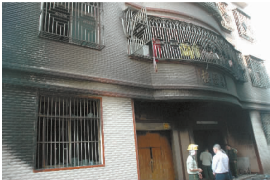
3月26日,消防人员在出事地点勘察。
