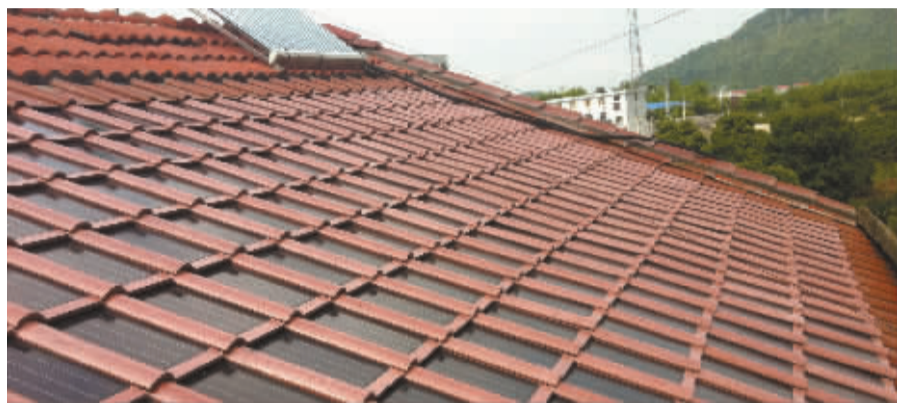
宁波合大屋顶能源公司位于鄞州龙观乡居民屋顶的光伏电站。
