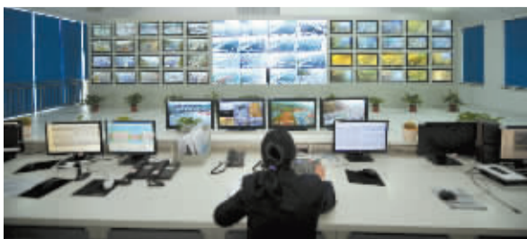
象山港大桥监控分中心。
