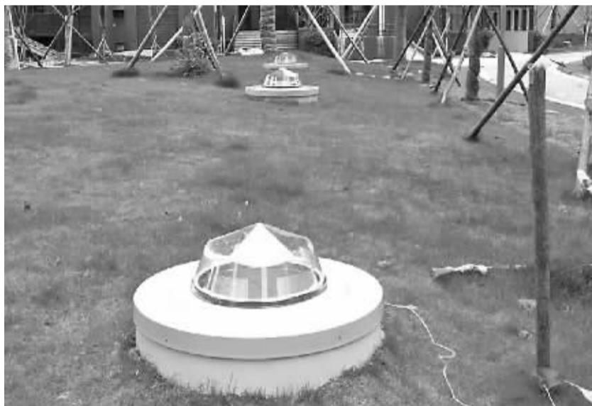
江北湾头安置房地下停车场安装了“光导照明”产品, 每年可节电 6 万千瓦时。
