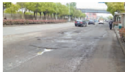
养护前的康庄南路,路面坑洼,容易产生积水。
