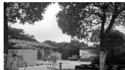
据了解，在相关部门的要求下，开发商已从5月20日开始拆除该违法搭建。
