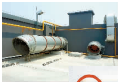
上图:印象城顶楼的油烟排风口。
