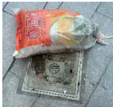
为防粪便喷出, 居民用沙袋压住窨井盖。
