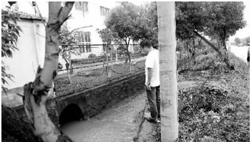
排污管排出铁锈色污水, 沟渠两岸因为长期浸润在污水中, 已经变色。
