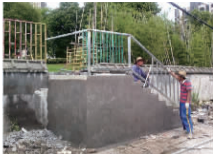
新三江口公园围墙外，两名工作人员在修建台阶。 廖业强 摄
