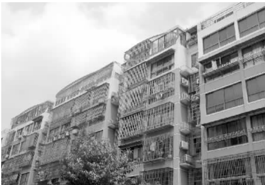
江北邻里花园楼顶违建。
