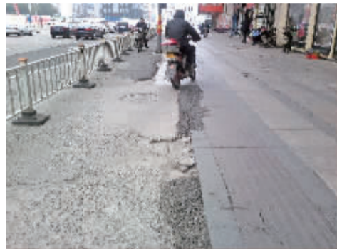
中山西路,坑洼不平的非机动车道。
