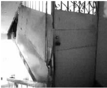
西陆小区5号楼4楼,上锁的铁门
