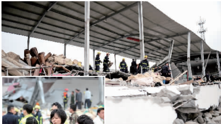
坍塌的厂房。记者 崔引 通讯员 颜杰 摄
