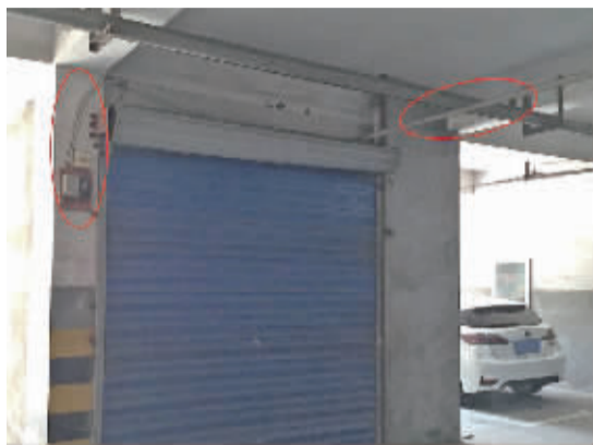
屋外私拉的电线和水管
