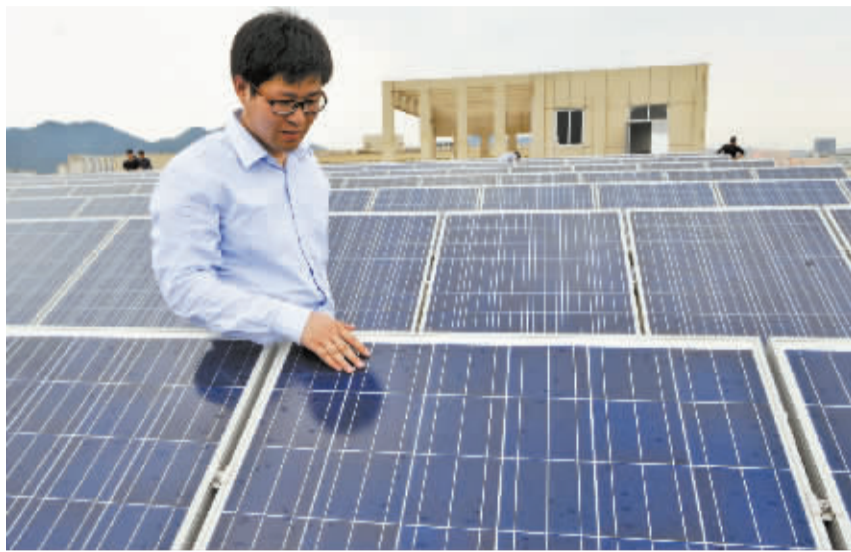
群创光电屋顶光伏电站。
