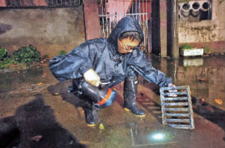
③ 在例行巡查中,陈淼发现了一个堵塞的窨井。
