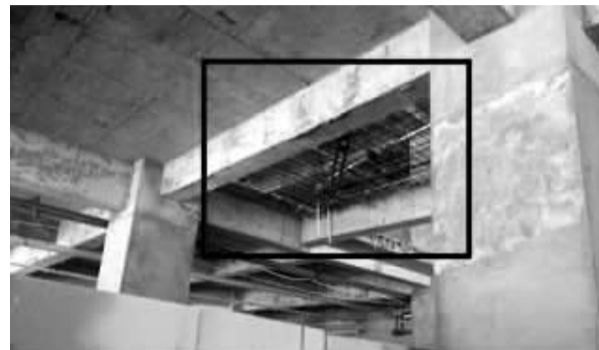
楼板的水泥被敲掉，钢筋裸露在外面
