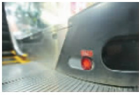
电梯内侧盖板底部
