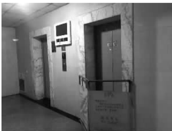
出事电梯已经封闭。
