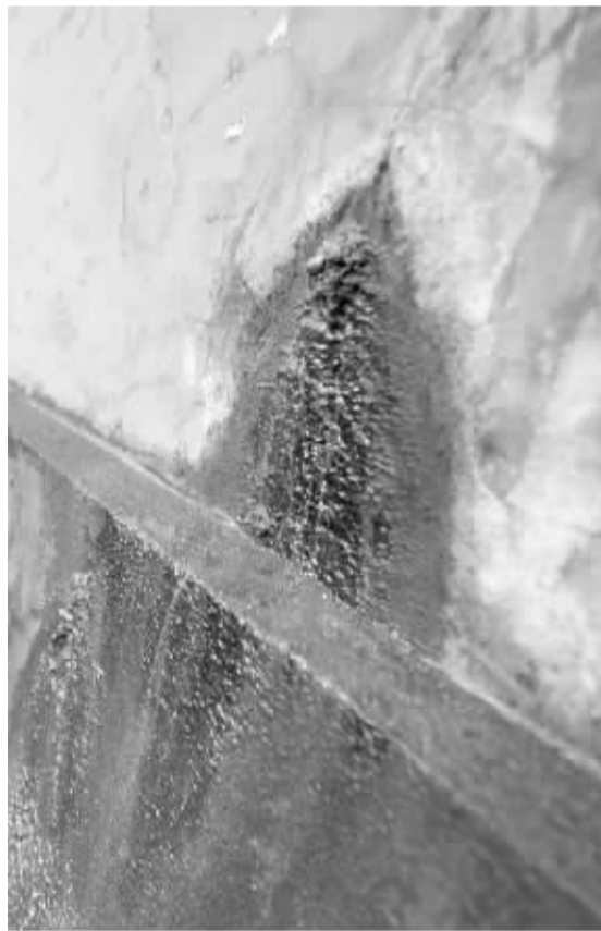
常洪隧道内一处渗水的墙面。 记者 崔引 摄
