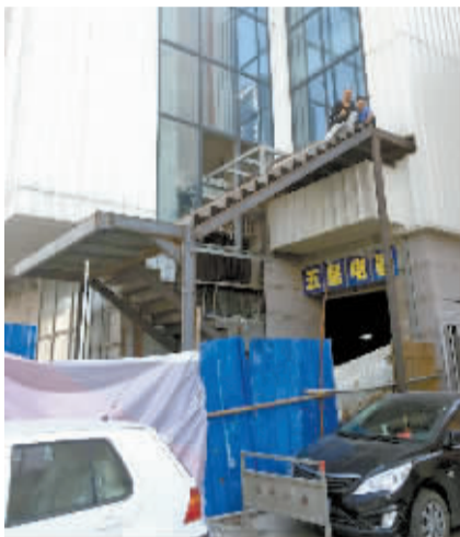
违章搭建的楼梯。
