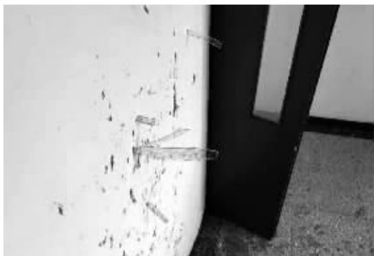
8月13日，附近居民楼震碎的玻璃插入墙壁。(网友供图)
