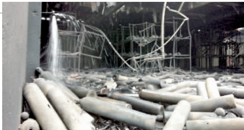
军事基地一处破损的建筑内景。
