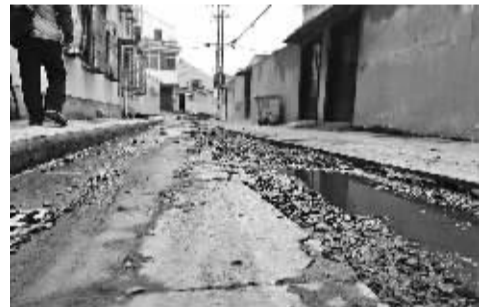
村里还有部分道路未修复。记者 崔引 摄
