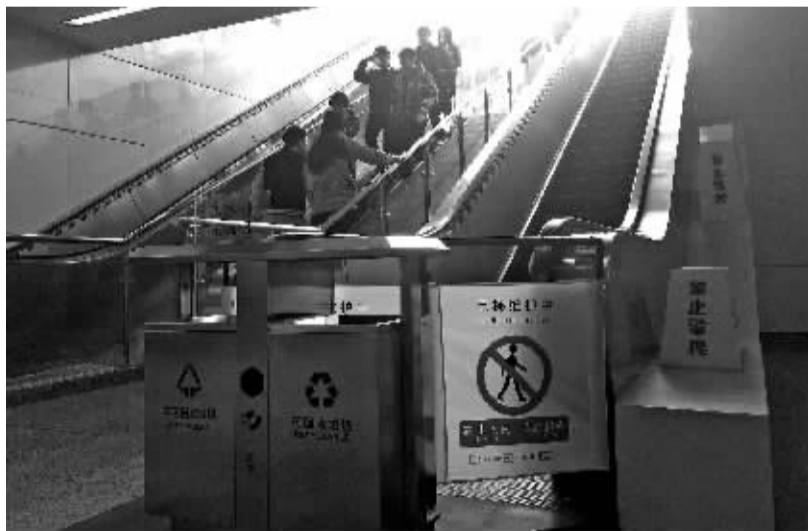
发生故障的扶梯已经被停运。 记者 乐晓立 摄
