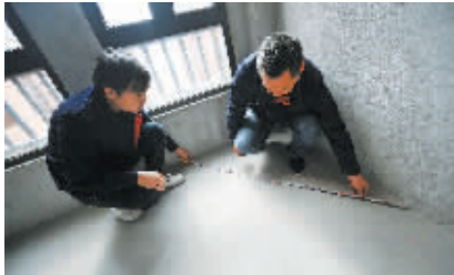
发现一处细小裂缝。
