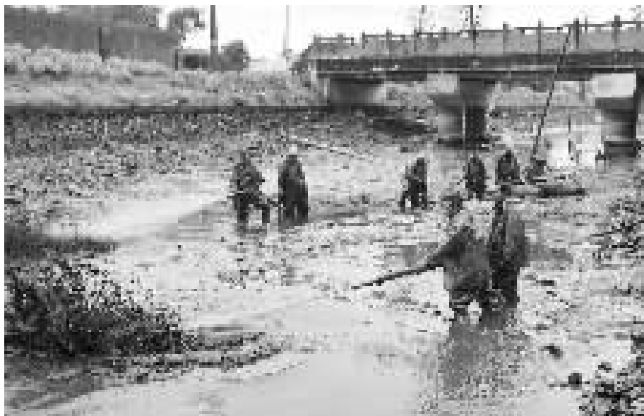
昨天,工人们正抓紧时间对位于镇海区骆驼街道的五星河进行河道清淤疏通作业。该河道预计于4月底完成整治工作。 记者 徐文杰 通讯员 陆金妹 摄
