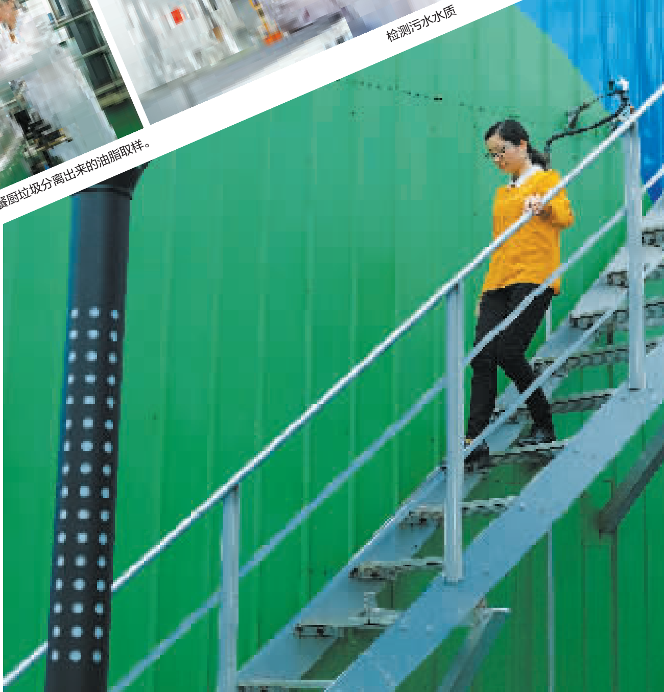
黄安娜在巡查厌氧罐。
