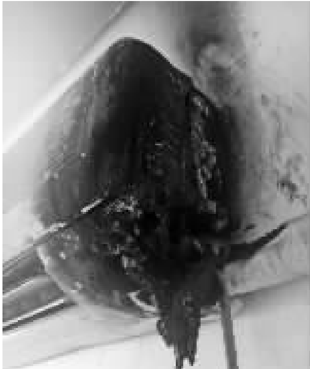
俞先生家被烧毁的空调。
