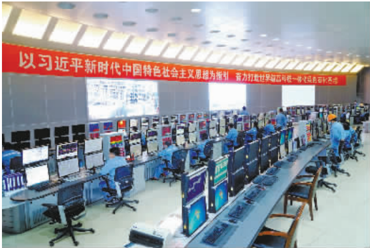
镇海炼化智慧工厂控制中台
