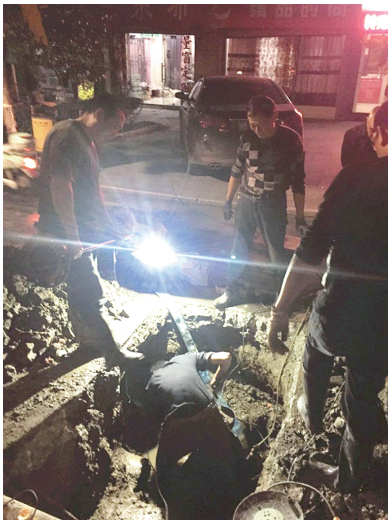
原定下午才能完成的抢修提前到中午12时前结束,东郡尚都和丽江名庭两个小区的供水得以恢复。图为深夜抢修。
