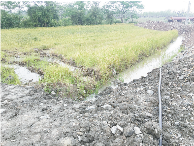
图为淤泥堆积后堵塞的排水沟。
