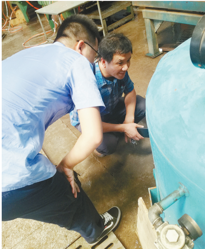
▲8月7日,宁波市恒源铸造有限公司厂区内,区市场监管局苑湖分局副局长陈武雷在检查厂区内特种设备,生产车间内的高温已然令他汗流浹背。夏季是特种设备事故频发的季节,尤其是制造业适用范围较广的压力容器易受高温影响。入夏以来,区市场监管局特设科及基层执法人员不畏酷暑,行走在比户外更火热的生产车间内,全面排查辖区内特种设备安全隐患。
