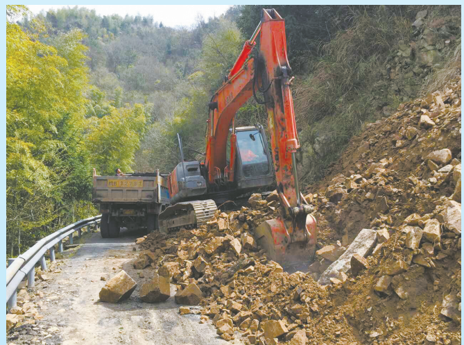
董东线塌方抢险
