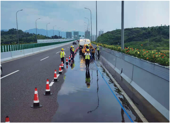
机场快速路奉化段道路积水应急演练
