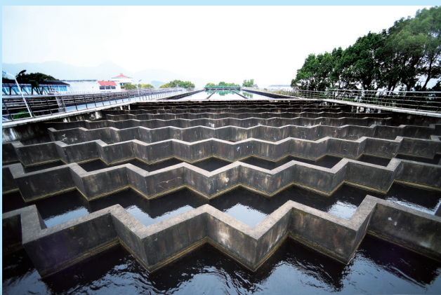
水厂折板反应池
