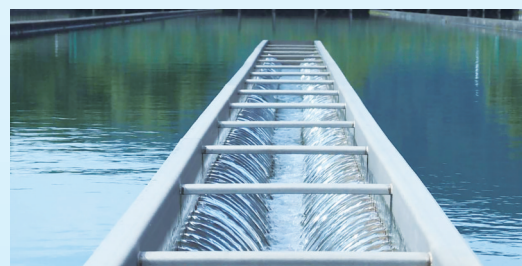
水经集水槽流向滤池
