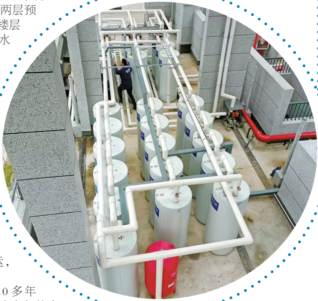
奉化人才公寓楼顶的空气能集中供热装置。
