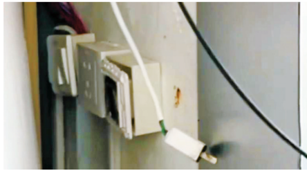
海曙轻纺城一商铺一只插头被烧坏。（林佳莹 摄）
