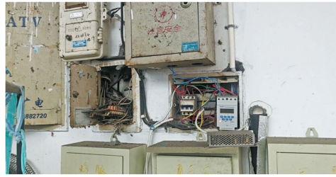
北仑弘基休闲广场电箱电线裸露。（史米可 摄）
