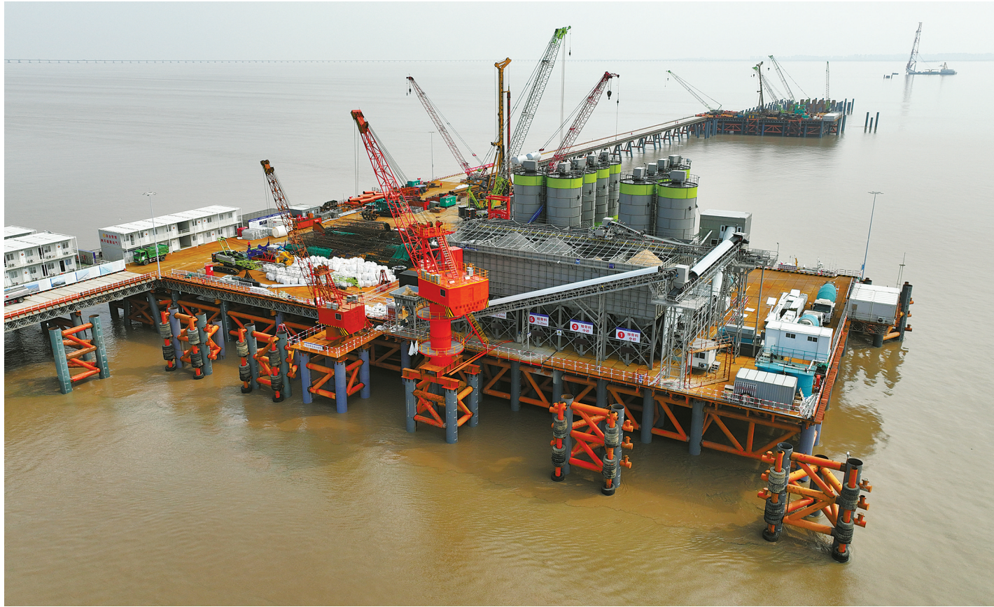
从正月初八项目复工开始,通苏嘉甬杭州湾跨海铁路桥施工现场就奏响了“交抢工期、瞄准节点赶进度、海浪的拍击声此起彼伏”。据悉,复工首日,工人开足马力,大桥南航道桥主墩施工现场,实现复工率100%。
