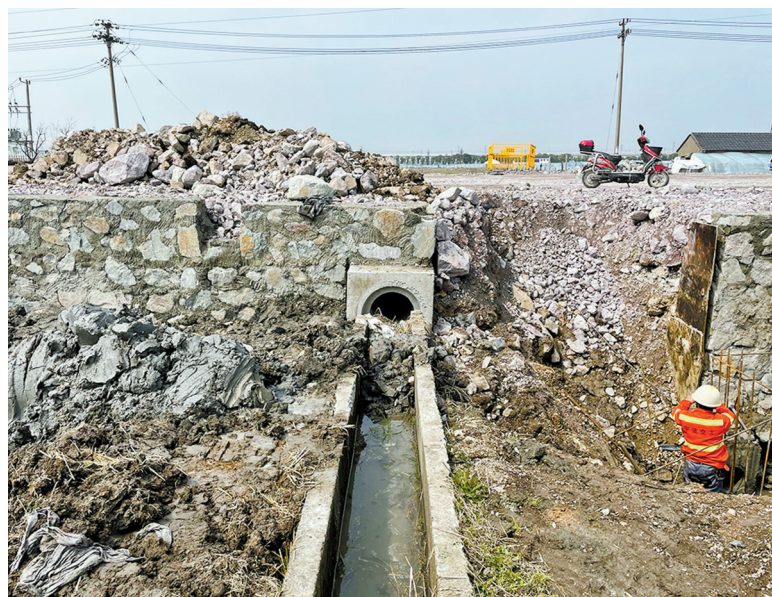
田间一条水渠被淤泥堵塞。（廖业强 摄）
