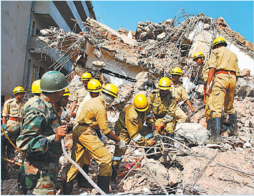
图为救援人员在楼房倒塌事故现场展开搜救。（新华社/法新）
