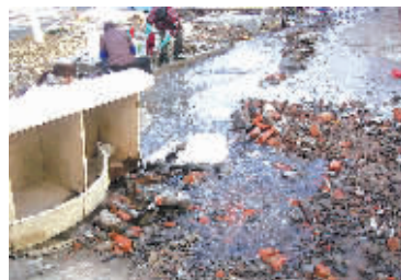
水管破裂,积水成“池”。(通讯员 摄)
