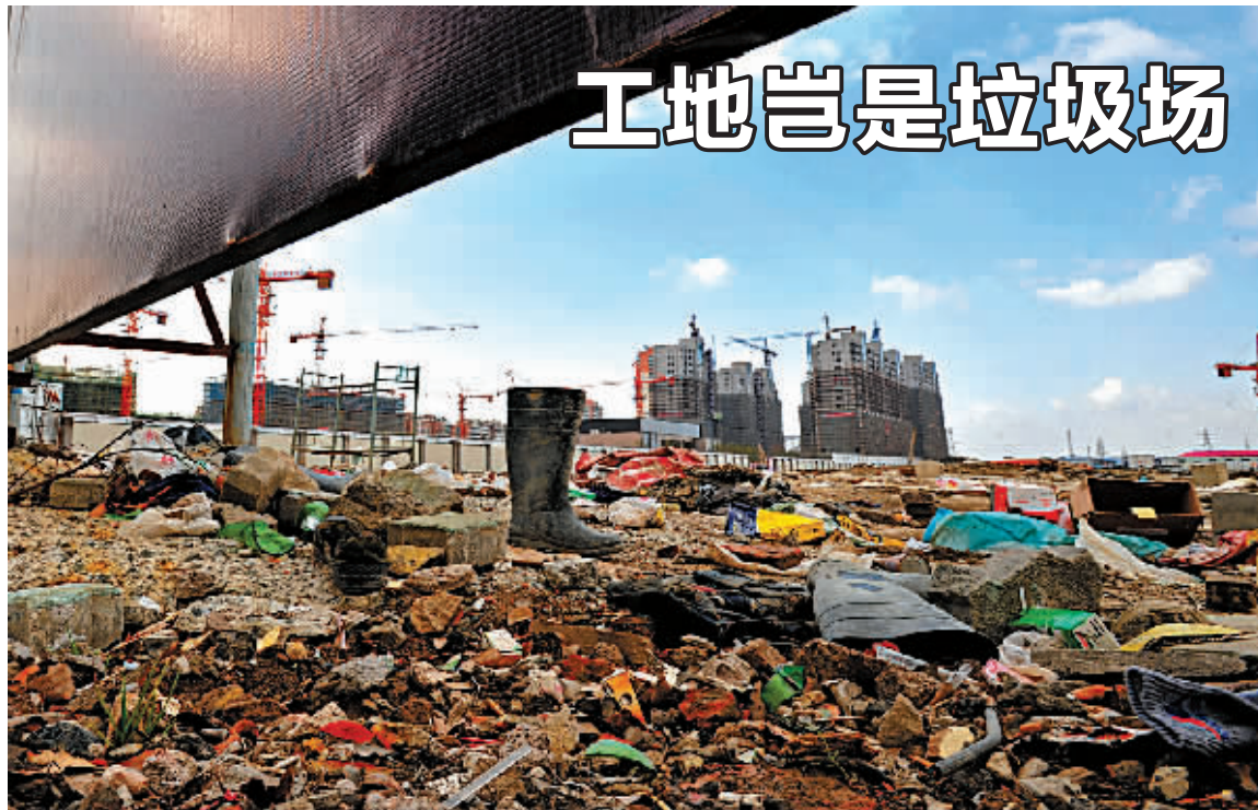
前天上午,在长丰桥旁正在施工的一个大型楼盘工地,记者发现在鲜亮的广告牌下,竟然堆着不少垃圾。工地并非脏乱差的代名词,开发商及施工单位还是应该楼盘、工地两个“形象”一起抓。(本报记者 摄)
