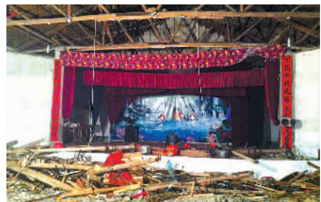
这是2月13日用手机拍摄的浙江省金华市磐安县万苍乡婚礼现场大会堂坍塌事故现场。（新华社发）
