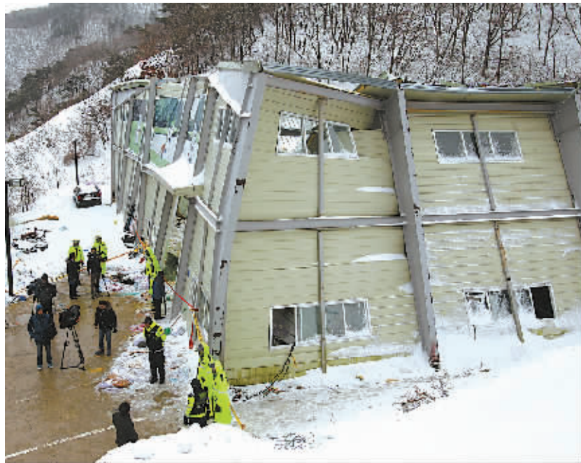
这是2月18日在韩国庆州市拍摄的发生坍塌事故的现场。(新华社发)
