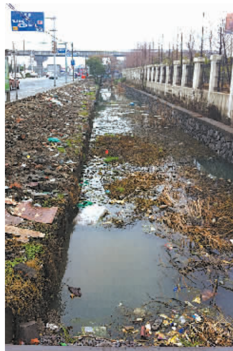
被垃圾堵塞的排水沟。
