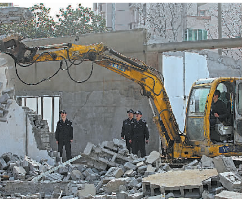
图为常青路南侧铁路地块内的1500平方米违法建筑被拆除。(胡建华 陈栋 蔡晓丰 摄)
