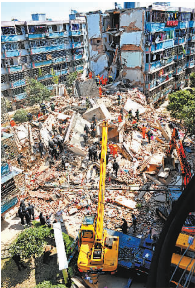
昨天上午，奉化市锦屏街道居敬小区29幢西侧楼房发生部分坍塌。（记者 严龙 李岩宏 摄）
